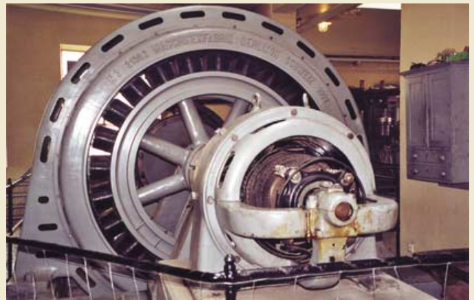
Bild 12: Der von der Maschine aus Bild 10 angetriebene Generator der Firma Oerlikon aus dem Jahre 1902.
